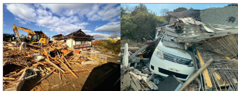
津波被害 珠洲市宝立町
