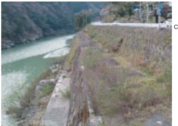
写真1 秋葉ダム湖の堆砂の影響（2004年3月29日） 佐久間町大輪地区では、1958年に約12km下流にできた秋葉ダム湖の堆砂の影響で川床が著しく上昇し、洪水の度に水害を受けるようになり、2度にわたって県道の付け替え工事を行わざるを得なくなった。当然住民の生活の場も、同時に山側へ山側へと急斜面の移住を余儀無くされた。 A：昔の生活の場 B：嵩上げされた県道のレベル C：更に嵩上げされた今の県道
