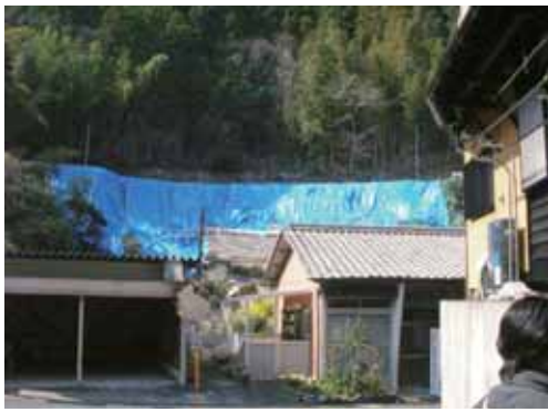
2006年7月の豪雨で崩れた湯出川沿い斜面
