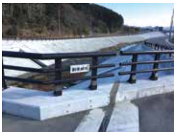
コンクリートで固められた新井田川とかさ上げ地（2019年3月撮影）
